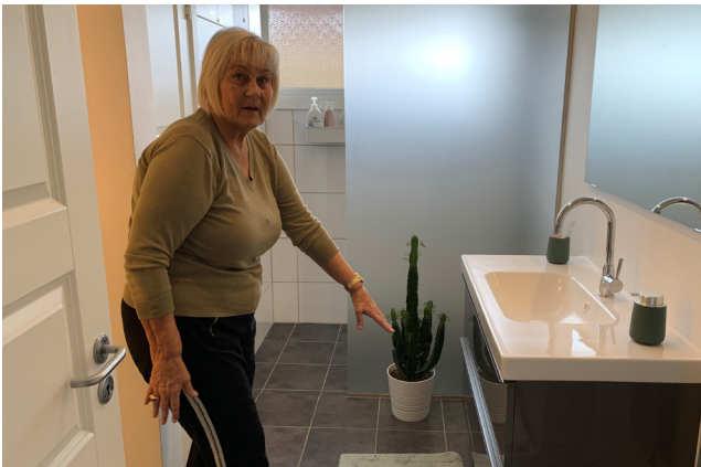
Merethe viser stedet for lækagen på badeværelset, som opstod under gulvet tæt ved afløbet under badeværelsesmøblet.
